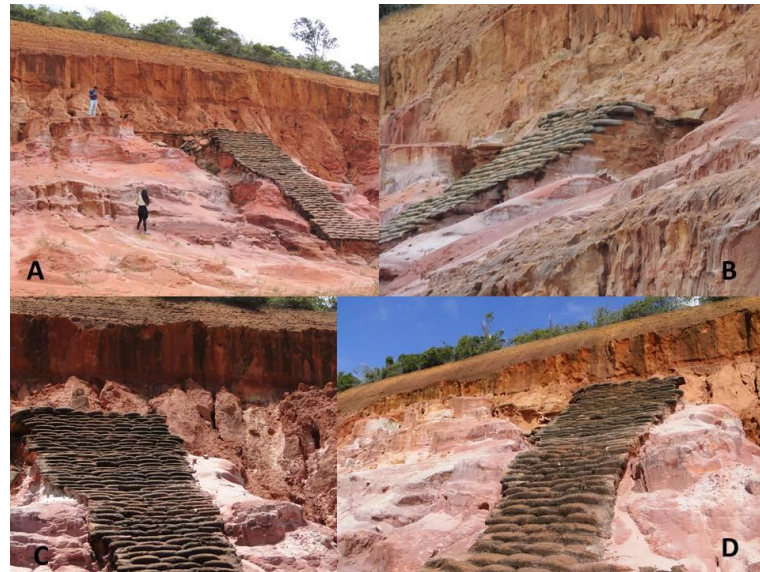
Figura 2: A, B- Contenção sacos solo cimento no ano de 2016. C, D- Contenção sacos solo cimento no ano de 2011. Fonte: Modificado do autor (2017).
