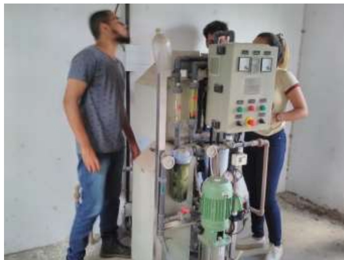
Figura 4. Unidade de dessalinização da comunidade de Malhada Nova- Santa Bárbara. Inoperante.
