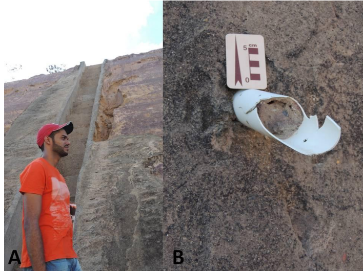
Figura 1: A- Canaletas do tipo escada em degraus atuando, como dispersor de velocidade das águas pluviais; B- Drenos totalmente entupidos, impedindo o escoamento das águas pluviais que infiltra no terreno. Fonte: O autor (2015).
