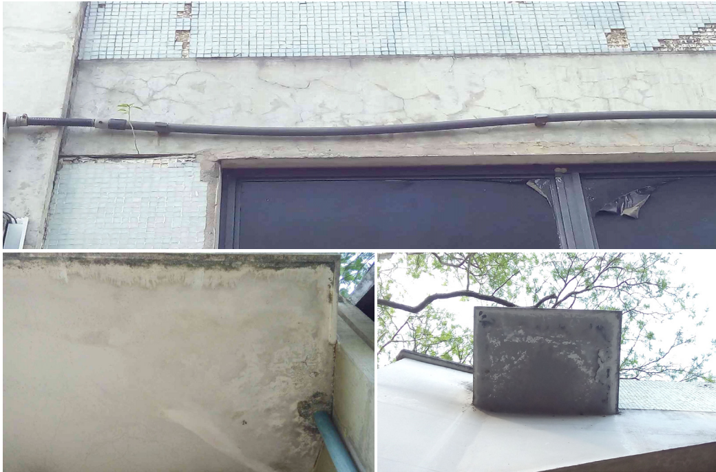
Figura 9 - Manifestações patológicas encontradas em vigas, lajes e calhas da Seção II
