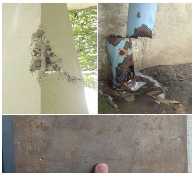
Figura 8 - Manifestações patológicas encontradas nos pilares da Seção I
