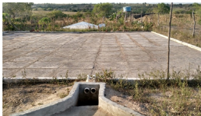
Figura 2: Cisterna calçadão do P1+2 no povoado de Canto, Serrinha-BA, 2016.
